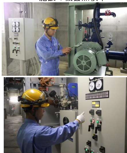
施設の機器点検中
