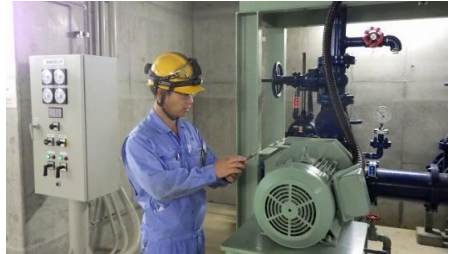
施設の機器点検中
