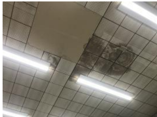
天井の雨漏りのようす
