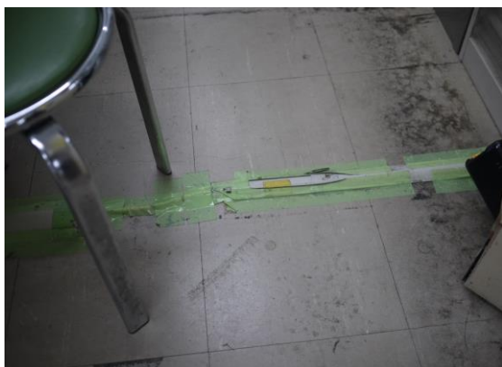
床上配線の様子
