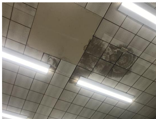
天井の雨漏りの様子
