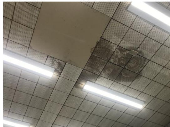
天井の雨漏りのようす
