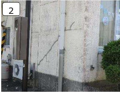
1 紀見地区公民館 外壁 さび汁あり
