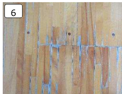
5 学文路 S C 体育館 内壁 めくれ
