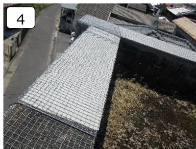
3 紀見北地区公民館 屋上 ひび割れ
