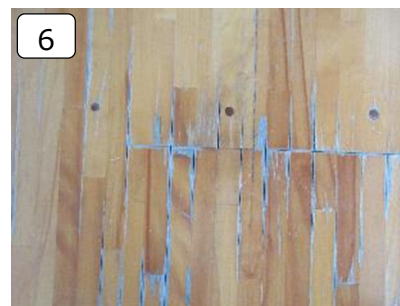
5 学文路S C体育館 内壁 めくれ
