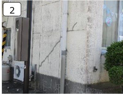
1 紀見地区公民館 外壁 さび汁あり
