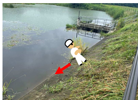
(ため池堤体の急傾斜)
