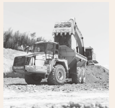
あやの台北部用地において進めている企業誘致用地の造成工事の様子。
