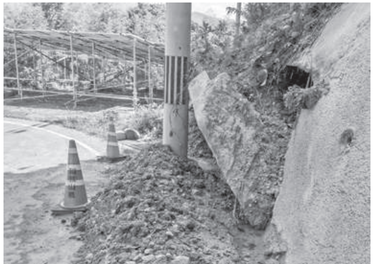
崩れた法面(応其)
