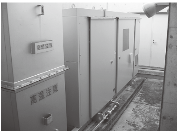
県立橋本市体育館に設置されている自家発電機
